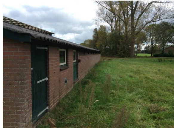
Figuur 9: Geen dakgoot aanwezig
