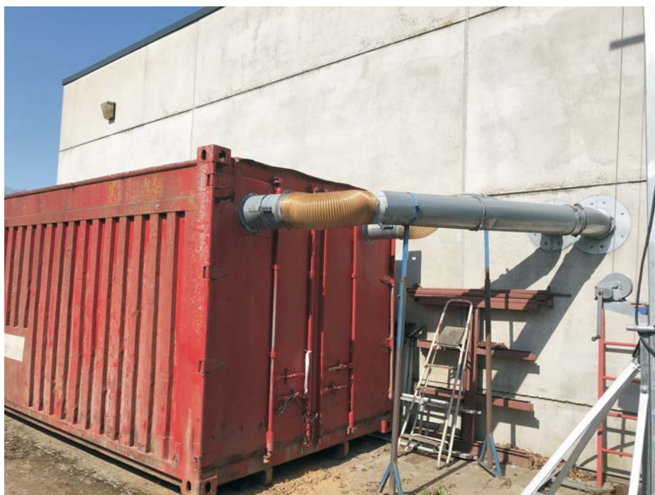
Afzuiginstallatie met container
