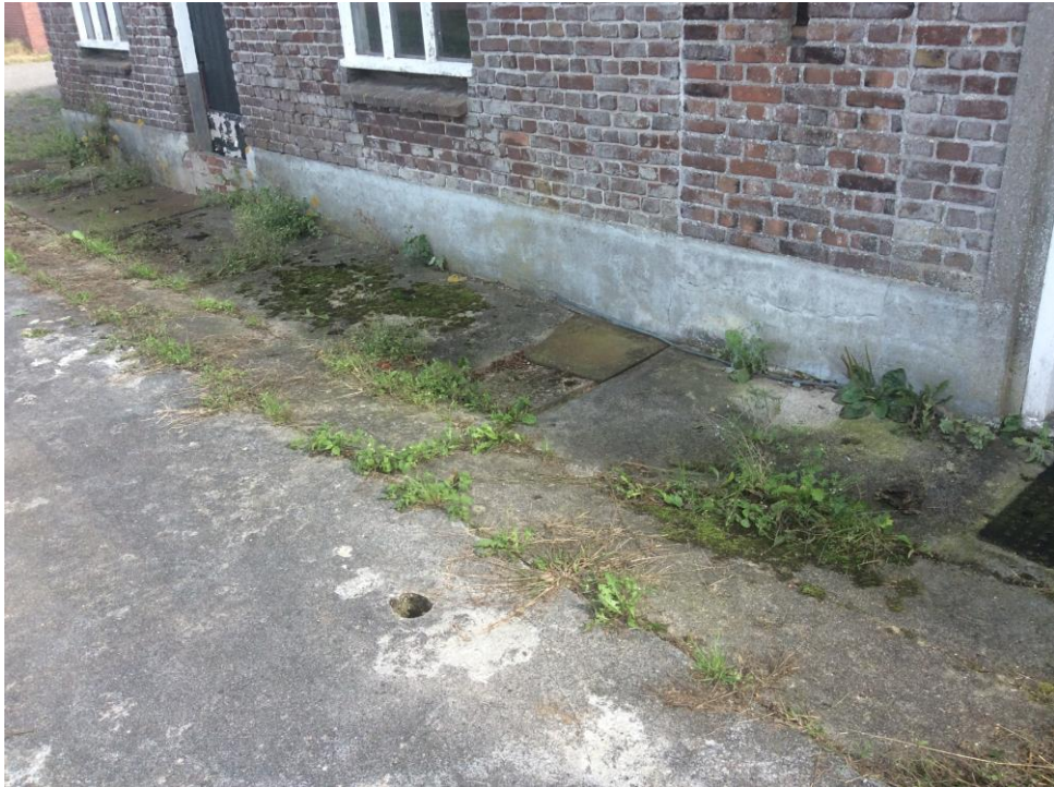
Locatie tank D (vml. bovengrondse 1200 liter HBO tank)
