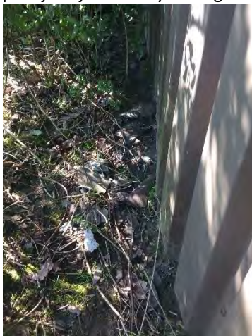
Figuur 10: Asbestverdacht materiaal op maaiveld
