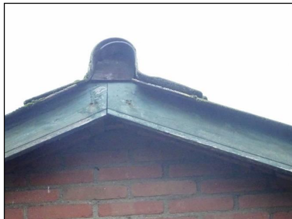
Figuur 15. Dakranden sluiten nauw aan en zijn daarom ongeschikt voor vleermuizen.
