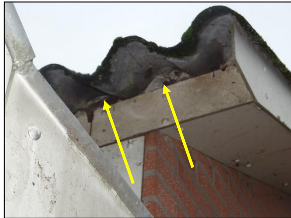
Figuur 12. Cement onder dakplaten varkensschuur.
