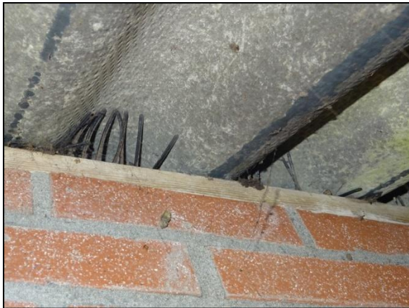
Figuur 11. Vogelschroot onder dakplaten varkensschuur.
