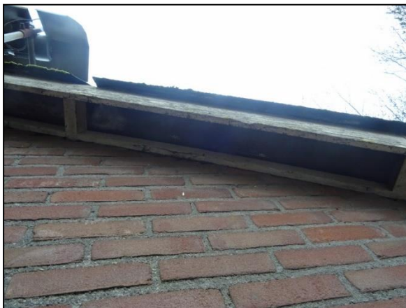
Figuur 14. Het overstek is open en biedt daarom geen wegkruipmogelijkheden voor vleermuizen.
