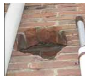
mogelijke verblijfplaatsen vleermuizen onder dakbeschot van de woningen (boven en midden) of in de spouwmuur van de fabriekshal (onder)
