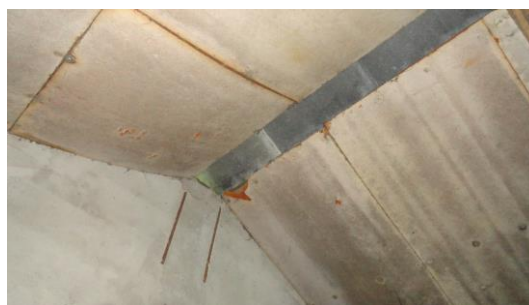
Afwerking onderzijde isolatieplaten (dupanel) schuur 1 Nokstukken asbesthoudend
