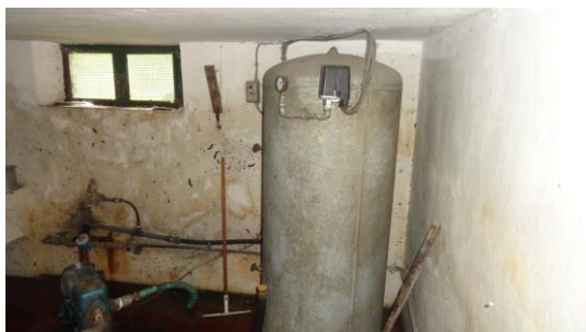
Kelder-boiler niet verdacht
