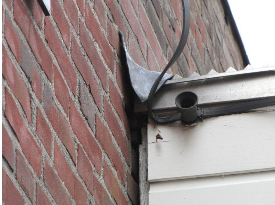
Figuur 6. Brede, voor vleermuizen ruim toegankelijke kier in het gebouw.
