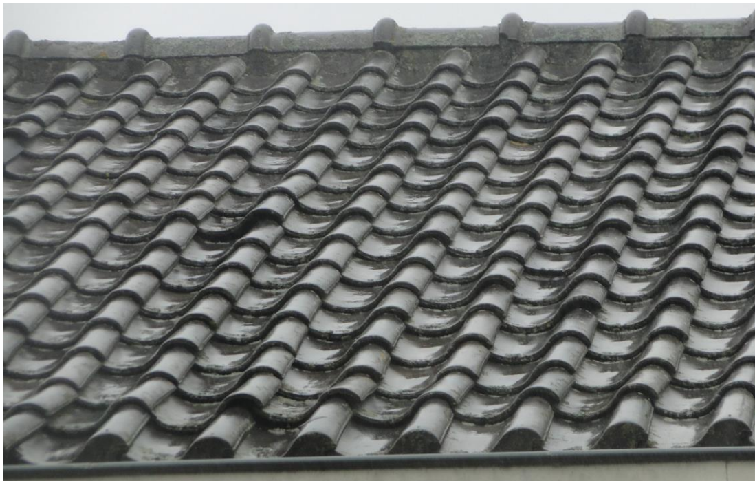
Figuur 8: Losse dakpannen op het pand aan de Van Leydenstraat in deelgebied 1
