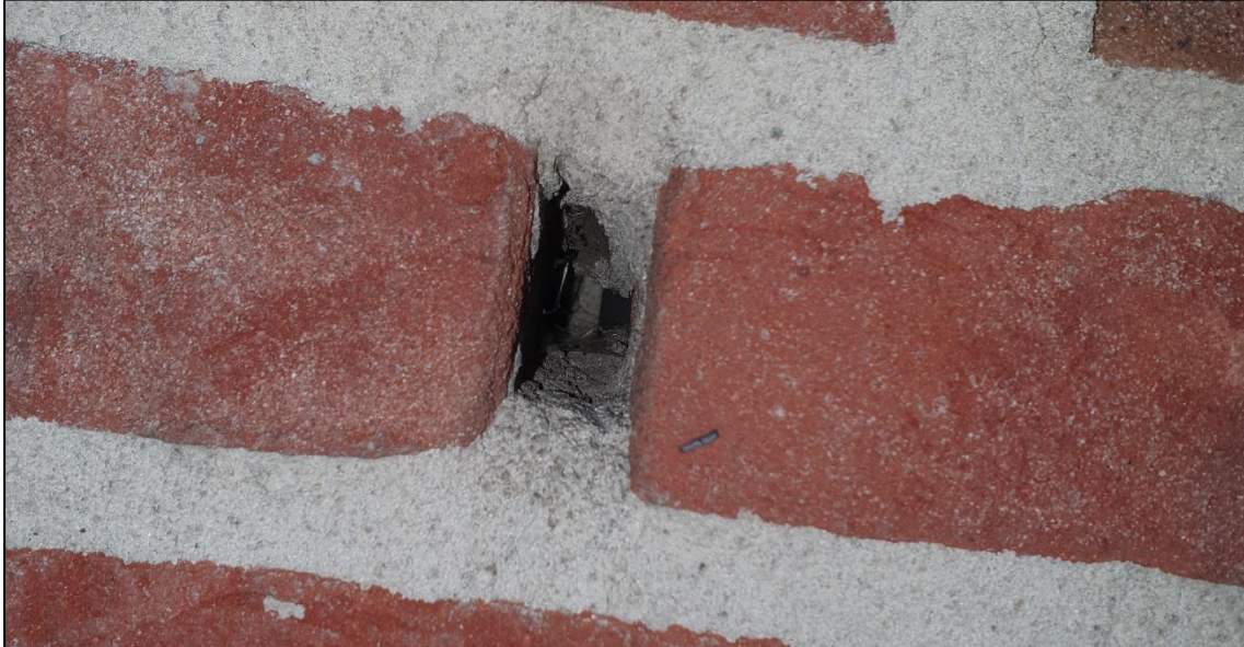
Figuur 8: De woning heeft open stootvoegen waardoor vleermuizen de spouwmuur kunnen bereiken
