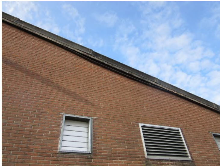
Figuur 4.3. Boeiborden met holle ruimte in het oude deel van de bedrijfshallen.
