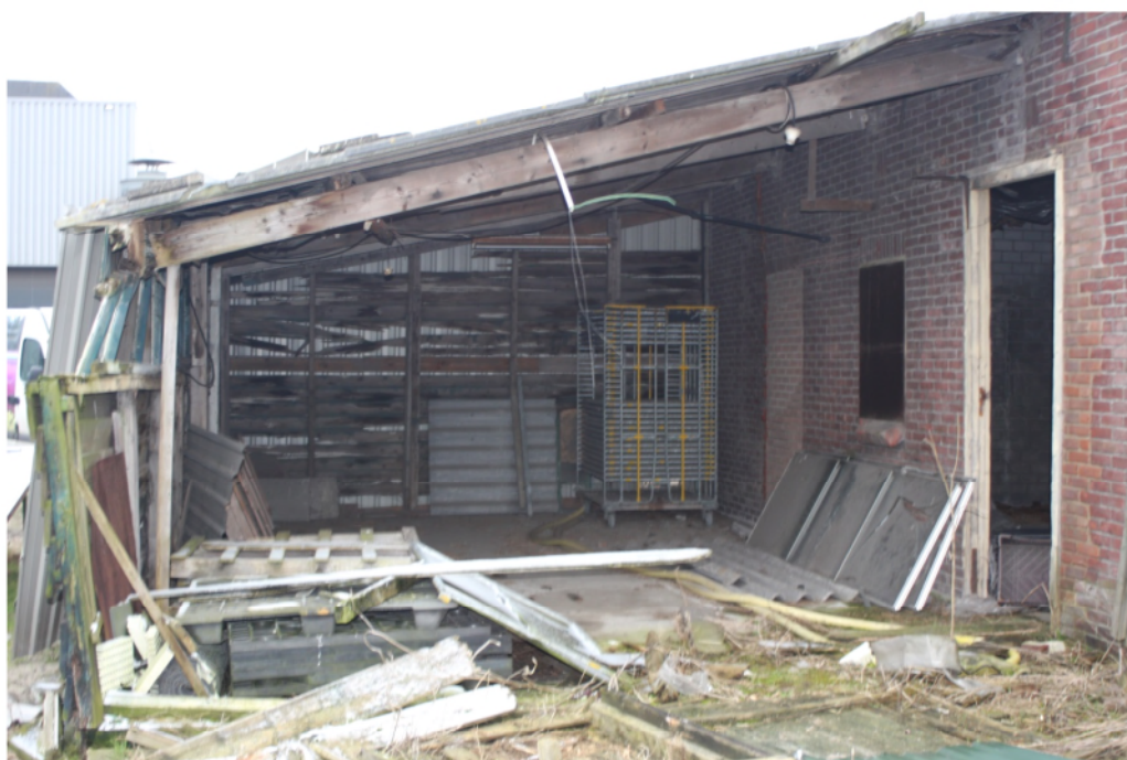
Figuur 3 Het gebouw is dermate vervallen dat er vele en grote gaten in het dak, de muren, ramen en het plafond aanwezig zijn.
