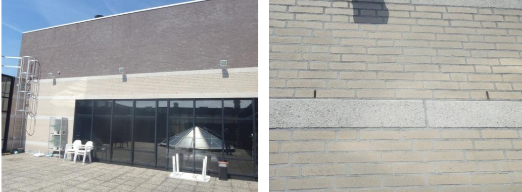
Afbeelding 4: open stootvoegen aan de zuidoostkant van het gebouw op de eerste etage, in de binnenplaats
