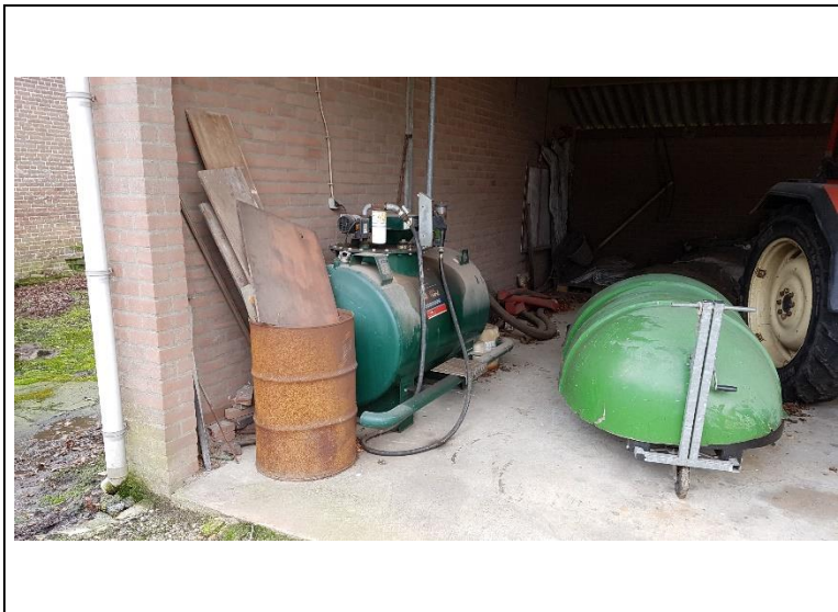
Foto 7: bovengrondse dubbelwandige brandstoftank in machineloods (gezien vanuit het noordoosten, 1 februari 2020)
