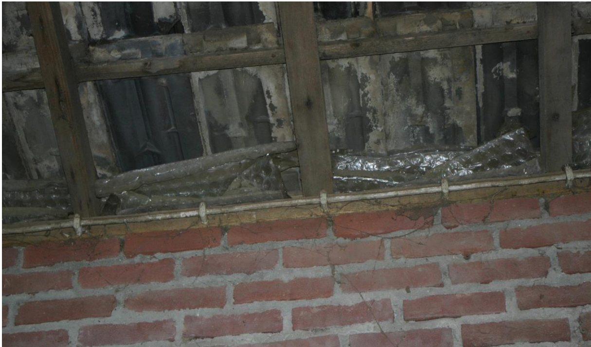
Figuur 4.5.1. Het dak van de schuur is aan de binnenzijde niet geïsoleerd of betimmerd.
