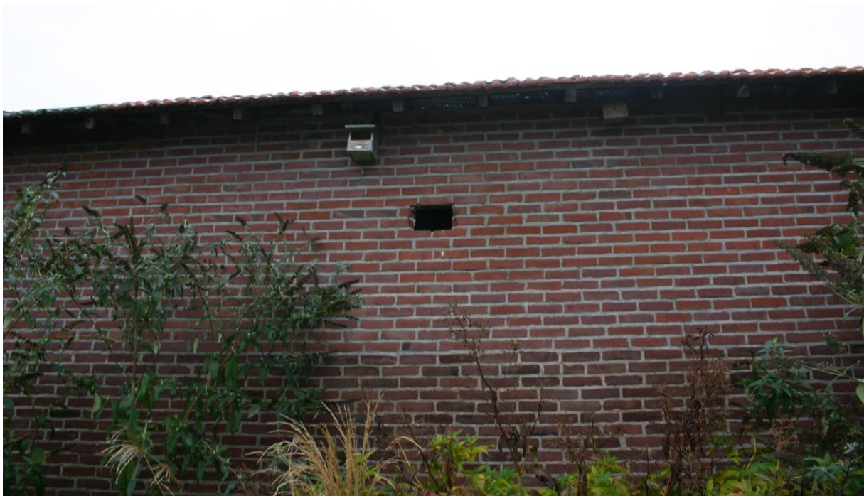
Figuur 4.5.2. In de oostgevel van de schuur bevinden zich twee gaten die vogels toegang geven tot de schuur (hier is één van de gaten weergegeven).
