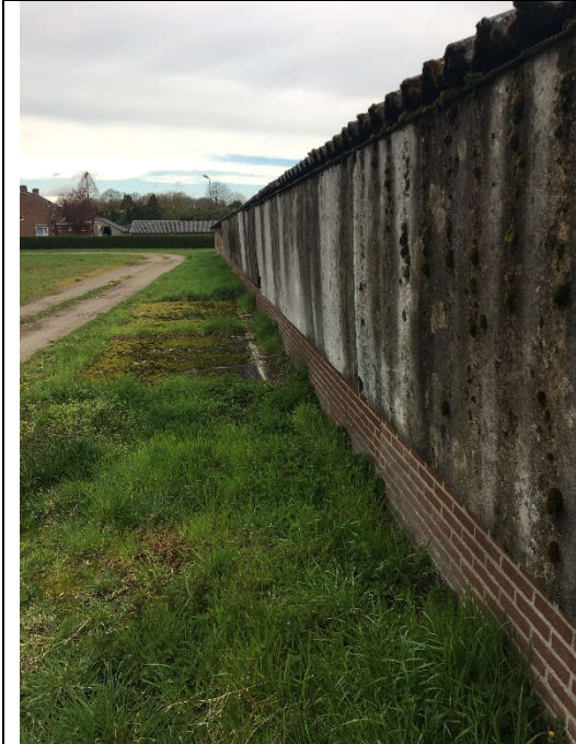
Zijde overwoekerde betonverharding
