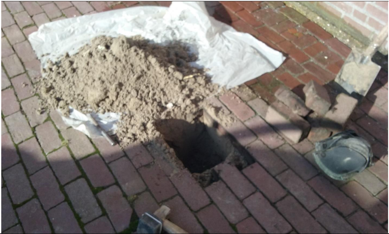
Foto B8.6 Asbestgat 24
