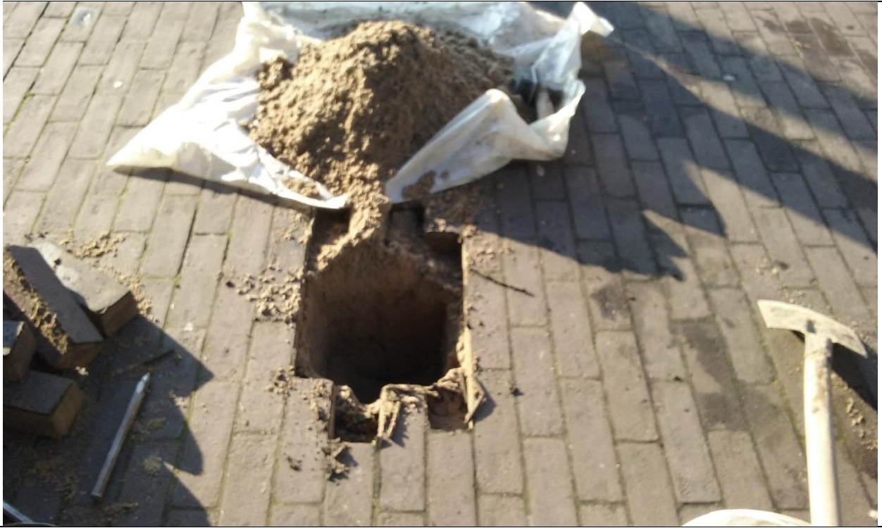
Foto B8.1 Asbestgat 30
