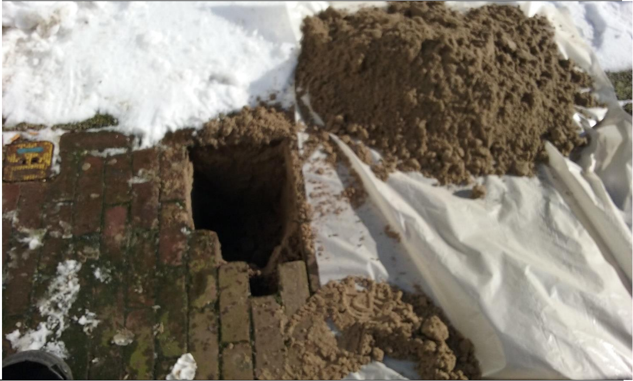
Foto B8.7 Asbestgat 23
