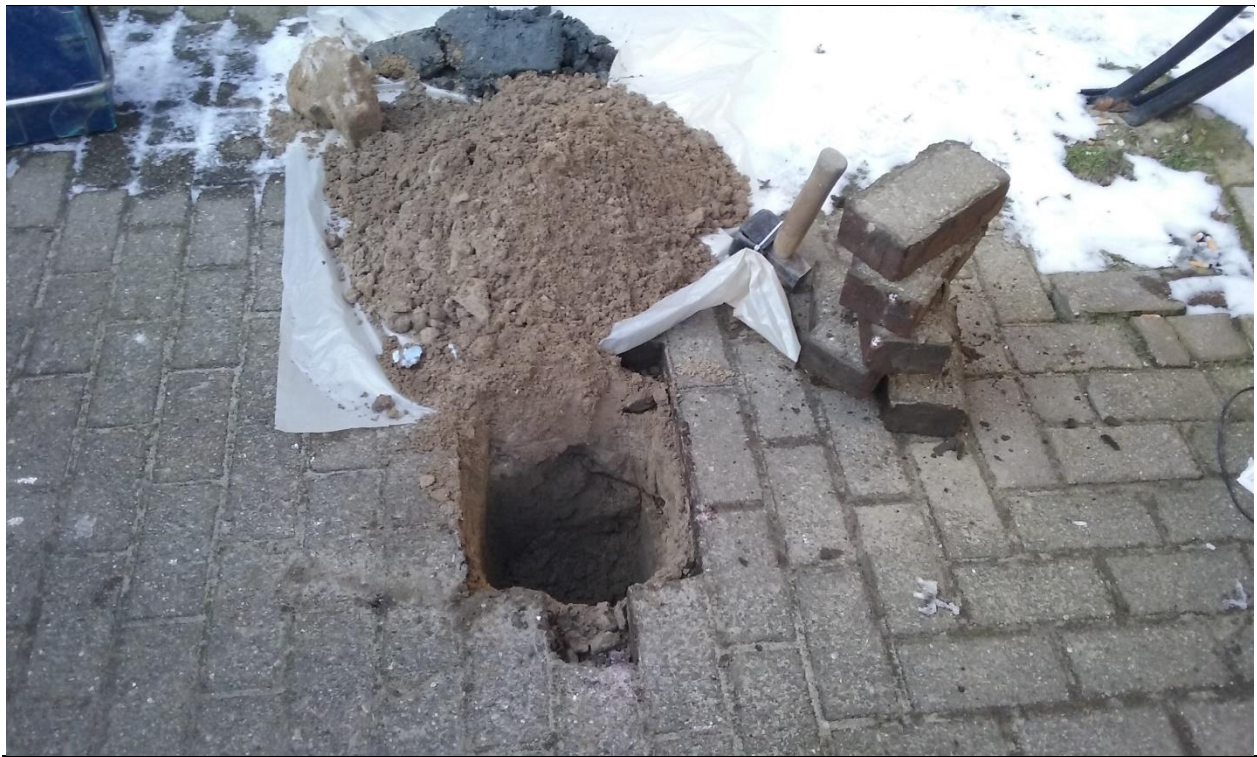
Foto B8.10 Asbestgat 31
