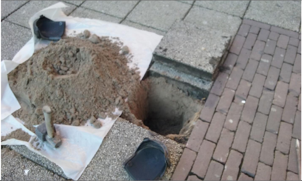
Foto B8.5 Asbestgat 25
