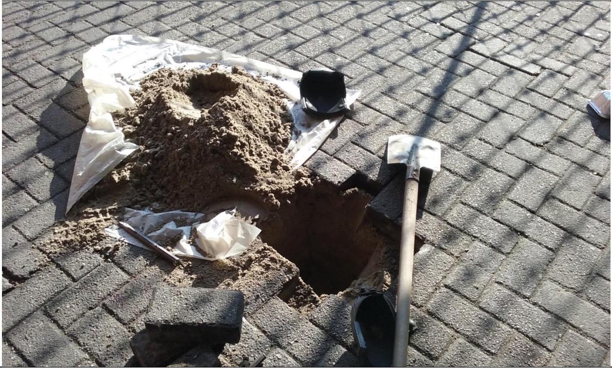
Foto B8.3 Asbestgat 27
