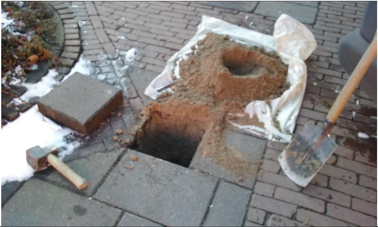
Foto B8.4 Asbestgat 26
