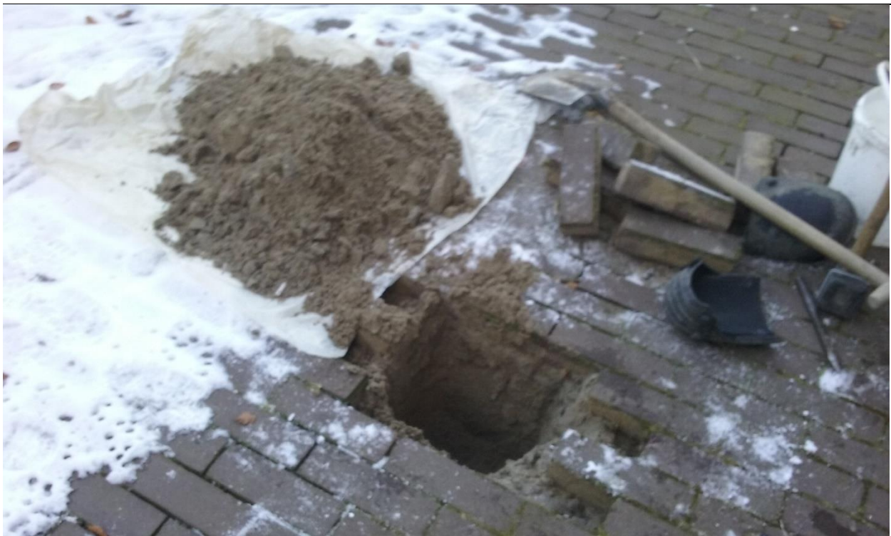
Foto B8.8 Asbestgat 22
