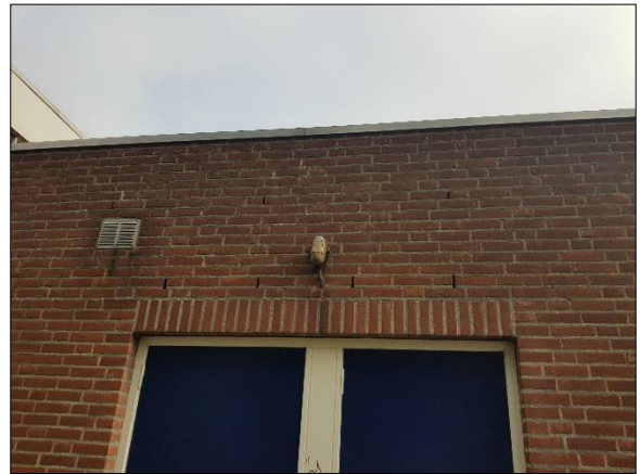
Figuur 8. Voorbeeld open stootvoegen in gebouw
