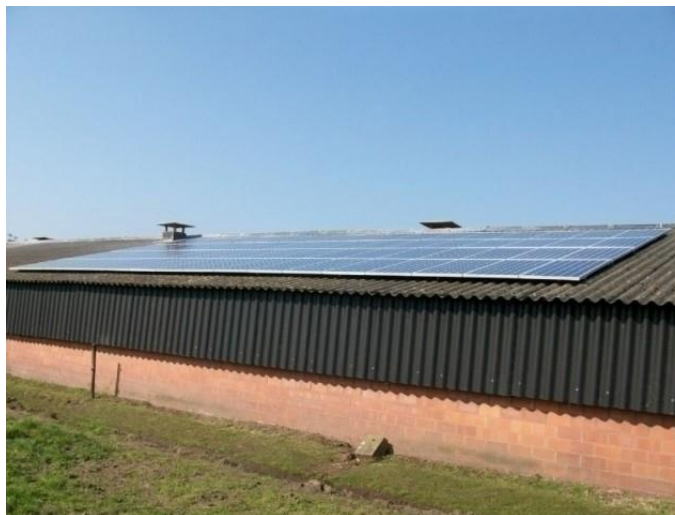
Zonnepanelen in het dakvlak.
