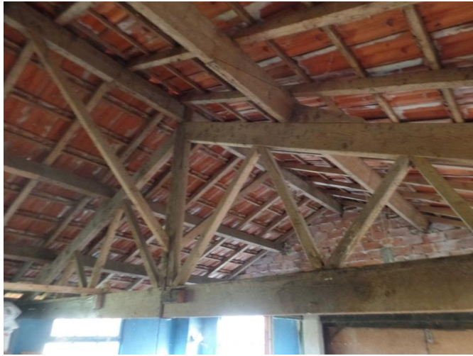
Geen dakbeschot aanwezig 1 e compartiment
