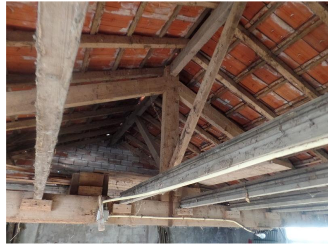
Geen dakbeschot aanwezig: 2 e compartiment
