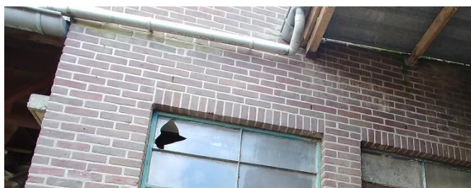
Figuur 13: Open stootvoegen noordgevel bedrijfskantoor
