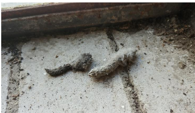
Figuur 16: Uitwerpselen van steenmarter aangetroffen in de silotoren
