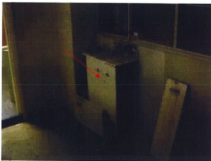
ruimte 1.3: asbesthoudende CV-ketel
