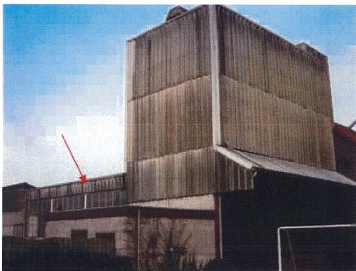
ruimte 1.5: asbesthoudende gevelbeplating
