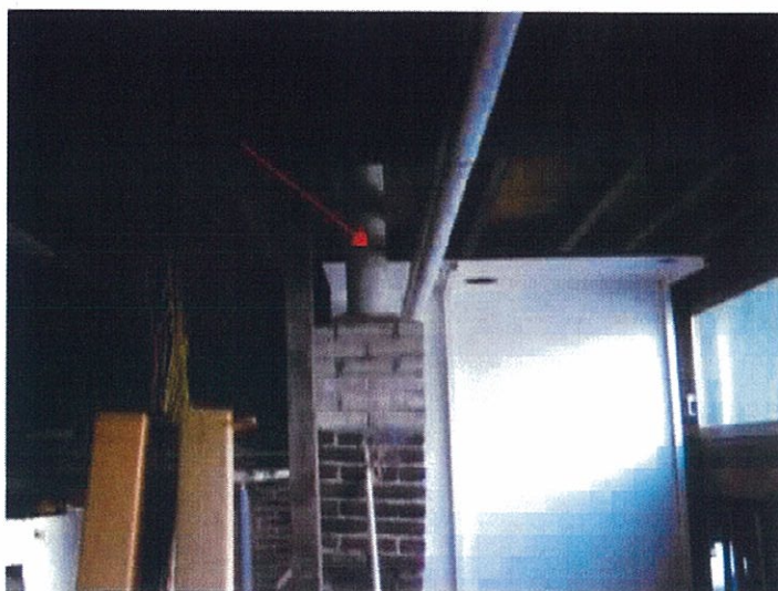
ruimte 2.1: asbesthoudende rookgasafvoer
