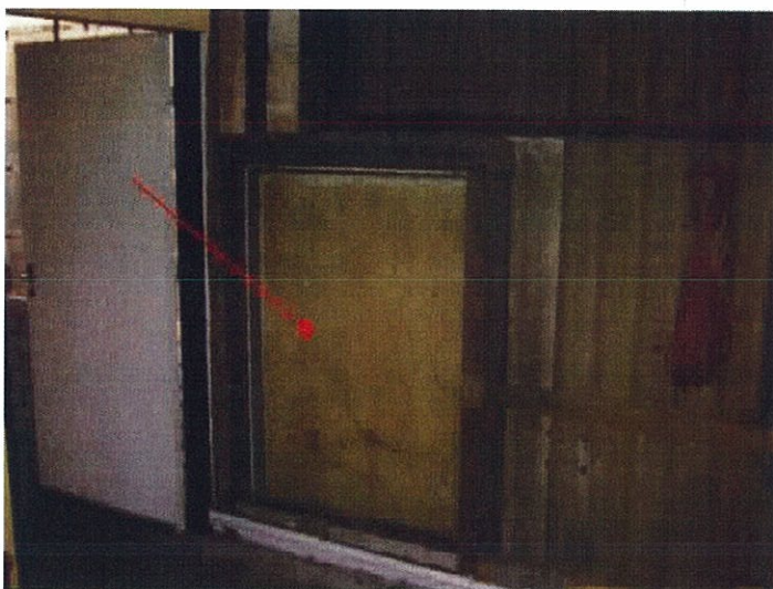
ruimte 1.7: asbesthoudende plaat op deur
