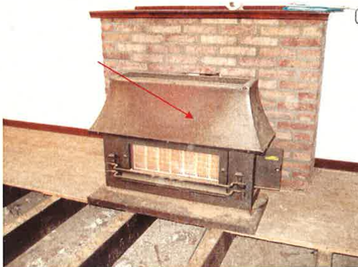
Foto 10: asbestverdachte gashaard in de woonkamer van Steegstraat 28.
