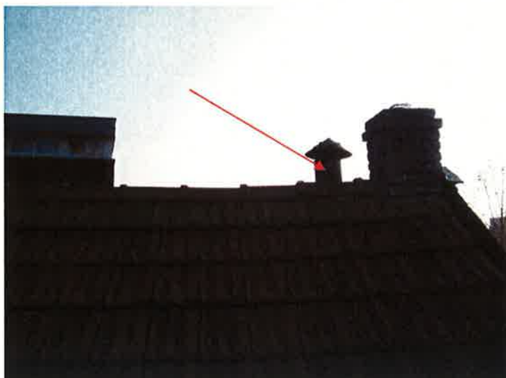
Foto 7: asbesthoudende pijp op het dak van Laurentiusstraat 88.
