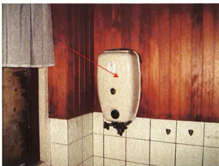
Foto 9: asbestverdachte geiser in de keuken van Steegstraat 28.
