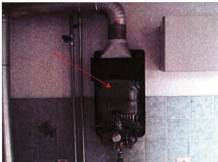
Foto 13: asbesthoudende geiser in de berging van Laurentiusstraat 88.
