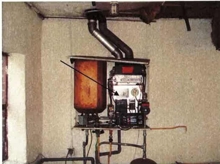
Foto 11: asbestvrije CV-ketel in de berging van Steegstraat 30.
