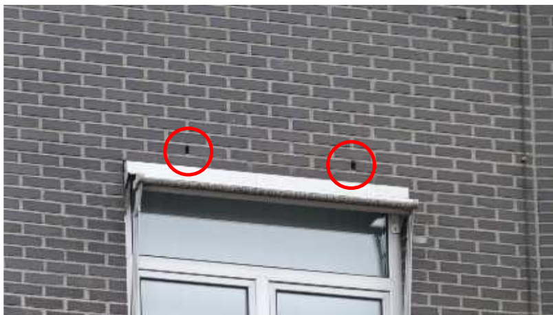
Foto 7. Open voegen (rood omcirkeld) in stenen muur van de te slopen bebouwing binnen het plangebied.
