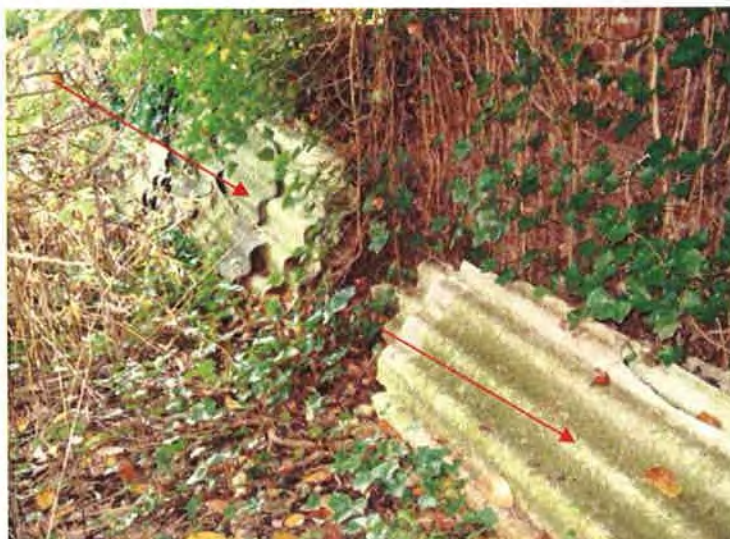
Foto 1: asbesthoudende golfplaten in de tuin van Steegstraat 28.
