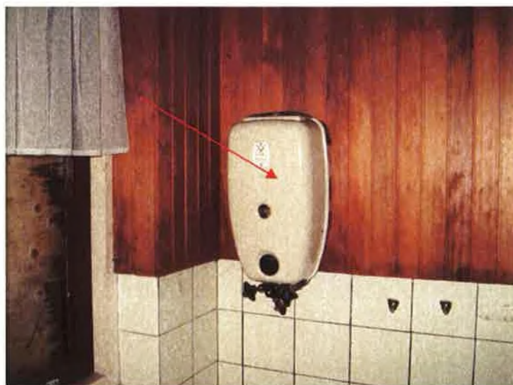
Foto 9: asbestverdachte geiser in de keuken van Steegstraat 28.
