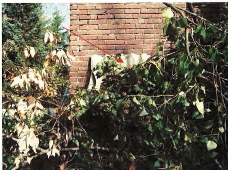
Foto 2: asbesthoudende golfplaten in de tuin van Steegstraat 28.
