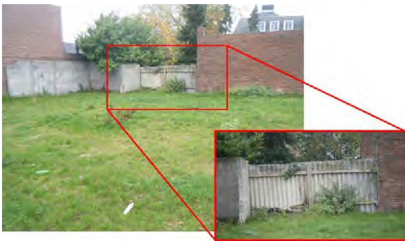
Afbeelding 2. Perceelsscheiding van asbestverdacht materiaal
