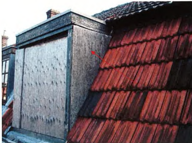
Foto 4: asbesthoudende betimmering van de dakkapellen op de 1 e verdieping van Steegstraat 28.
