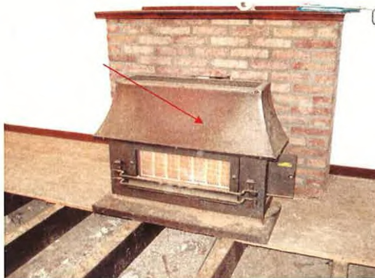
Foto 10: asbestverdachte gashaard in de woonkamer van Steegstraat 28.
