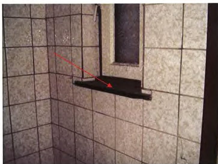
Foto 3: impressie van de asbesthoudende vensterbanken op de begane grond van Steegstraat 28.
