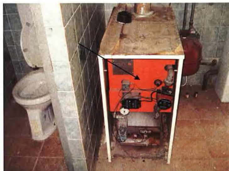
Foto 12: asbestvrije CV-ketel in de berging van Laurentiusstraat 88.
