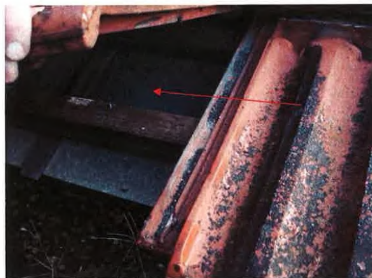
Foto 6: asbesthoudend dakbeschoot op het dak van Steegstraat 30.
