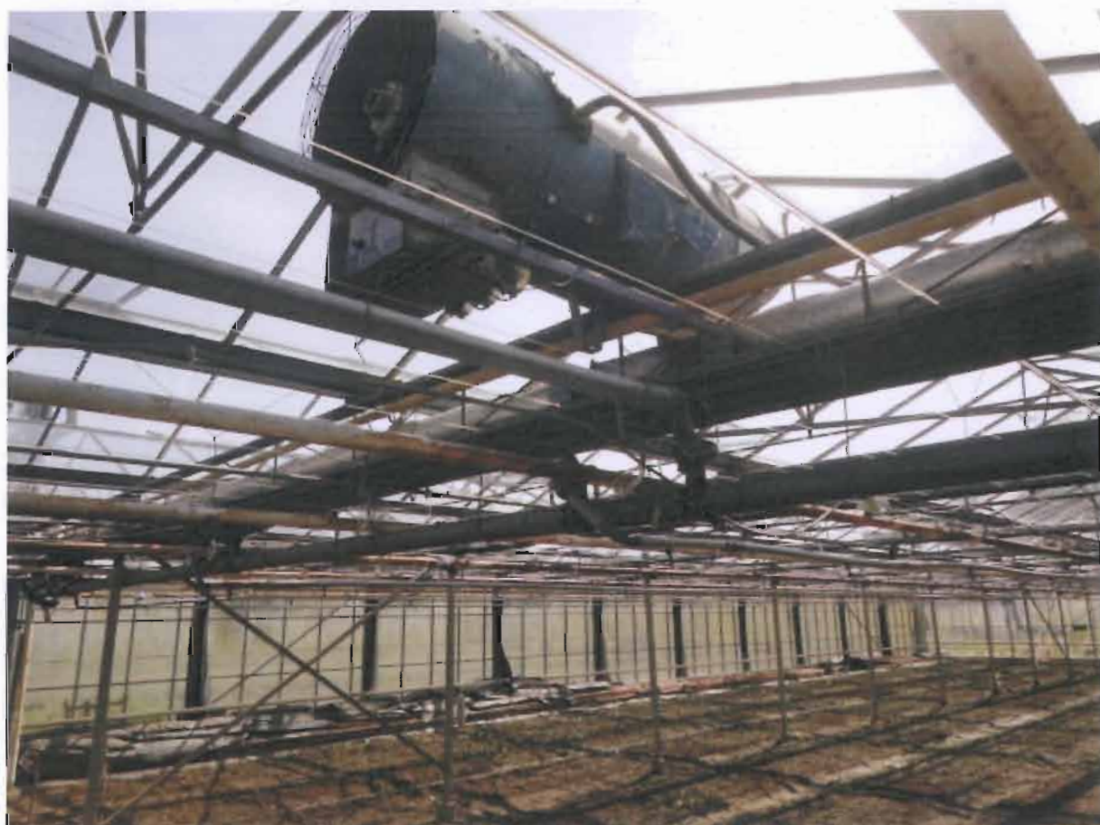
Foto 2: Op gas gestookte heaters in tuinderskas (14 mei 2012)
