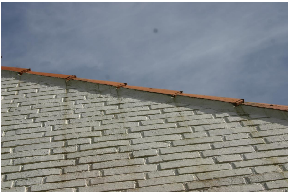
Figuur 7. De openingen onder de gevelpannen zijn met cement gedicht.
