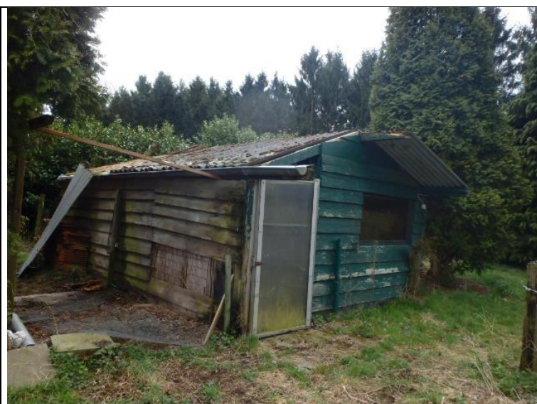
Foto 3: dierenverblijf met asbestverdachte golfplaten (gezien vanuit het oosten, 29 maart 2016)
