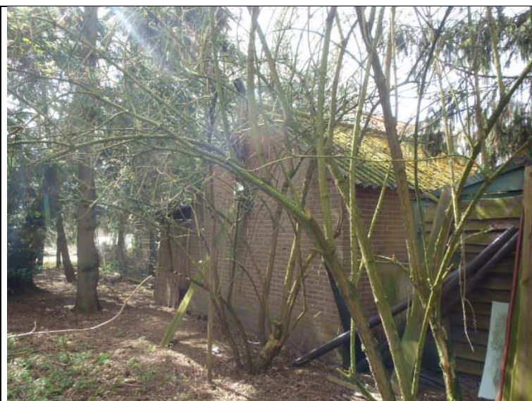
Foto 2: schuur / berging met asbestverdachte golfplaten ten oosten van woning (gezien vanuit het noordoosten, 29 maart 2016)
