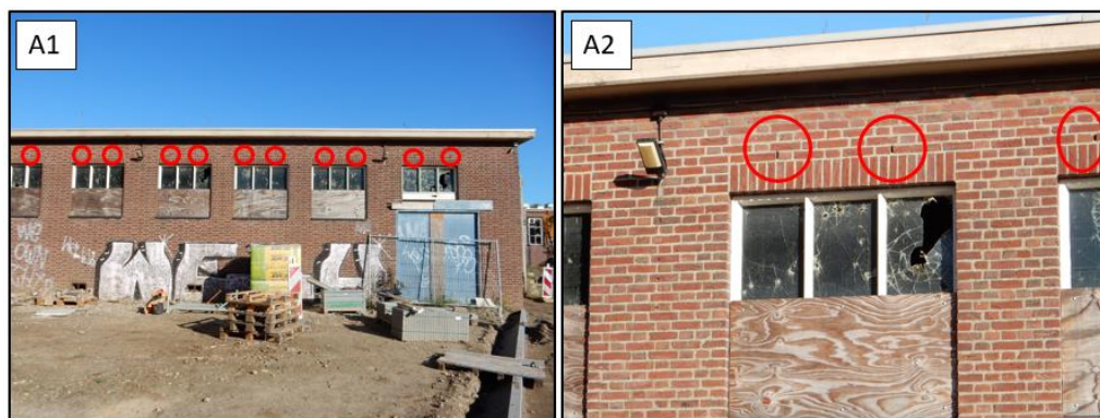
Figuur 5 Visuele representatie van een aantal open stootvoegen in Bijgebouw 1. (A1/2) Open stootvoegen aan de zuidwest zijde van bijgebouw 1.
