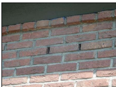
Figuur 12. Open stootvoegen in de buitengevel van de bedrijfswoning.
