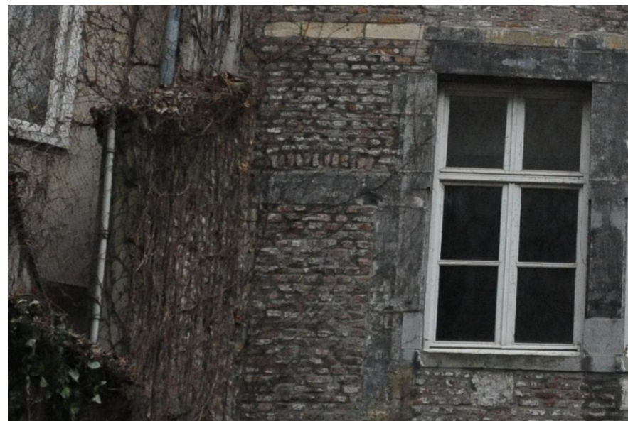
Afb. 10: getoogd metselwerk boven hardstenen ligger
