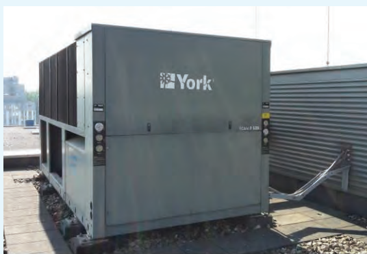
figuur 4: koelmachine op het dak van het Eurocentre
