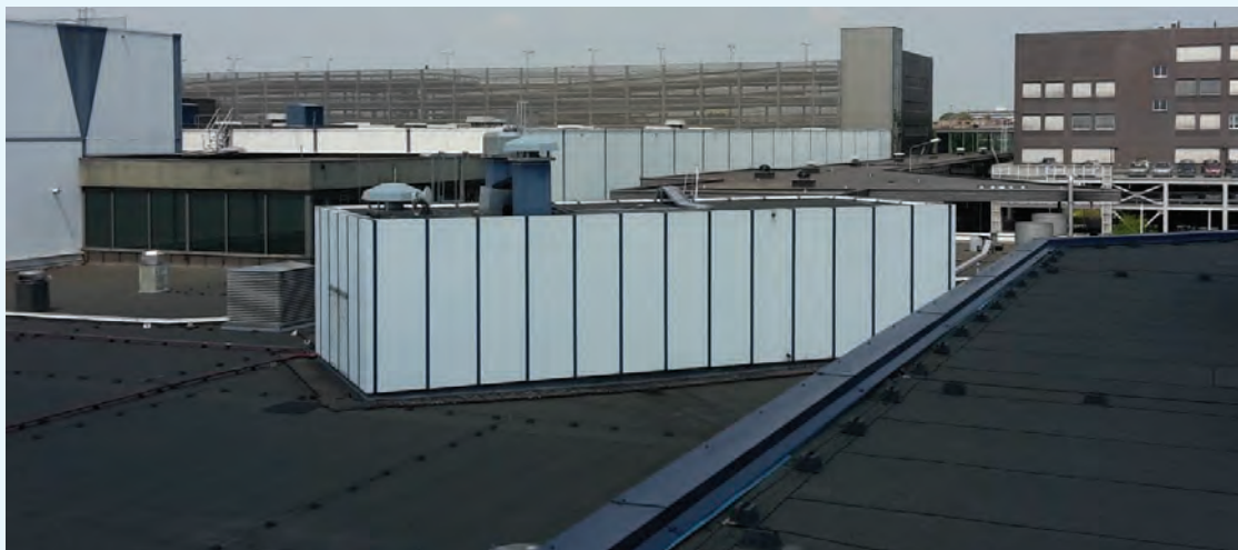
figuur 5: opbouw op dak catering (kijkend richting Noordhal en P5) met afzuiging keuken.
