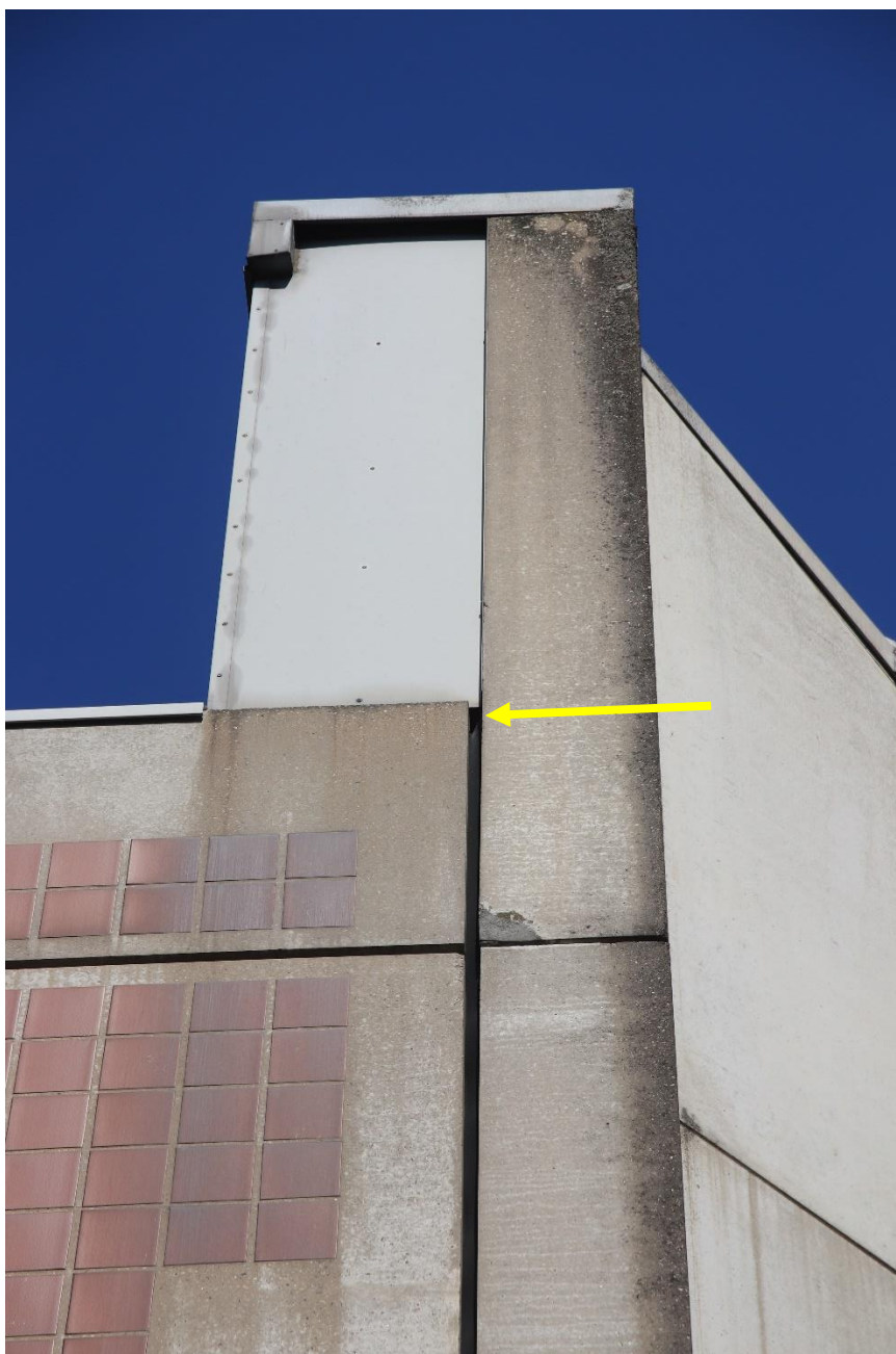
Foto 2: Terplekke van de gele pijl is het rubber tussen de betonelementen kapot. Hier kunnen vleermuizen (laatvliegers) een verblijfplaats hebben
