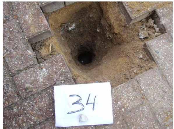
Foto 14: Onder de klinkerverharding van boring 24 is een puinlaag aangetroffen.
