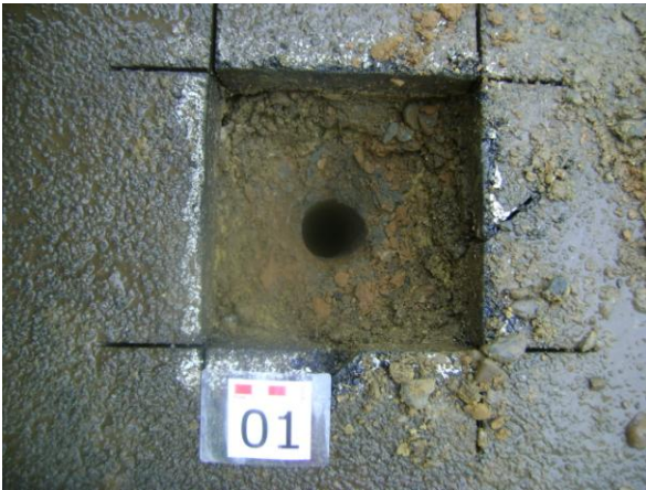
Foto 3: Een van de asbestgaten in de weg.
