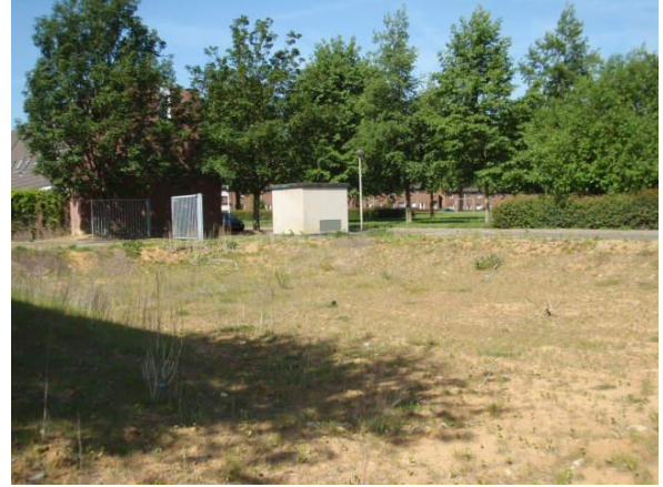
Foto 10: het transformatorhuisje ter plaatse van de kruising Poorterruwe/Arresruwe.
