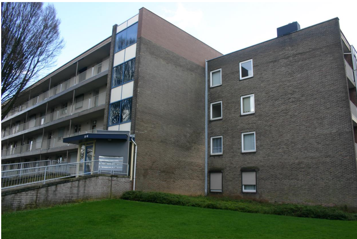
Figuur 4. Deze gevels (Prinses Irenestraat 53 – 115) bevatten vele open stootvoegen.
