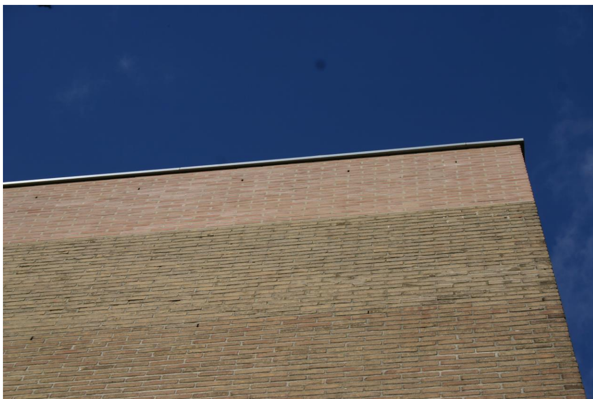
Figuur 3. Net onder de dakrand van het appartementencomplex aan de Spiessstraat bevinden zich meerdere open stootvoegen.
