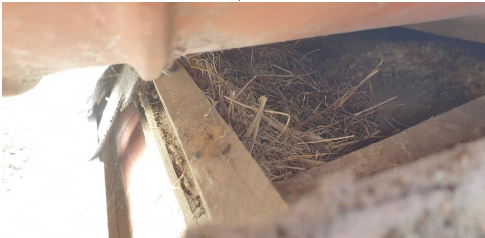
Foto 4. Nest van huismus onder een dakpan vlak boven de dakgoot
