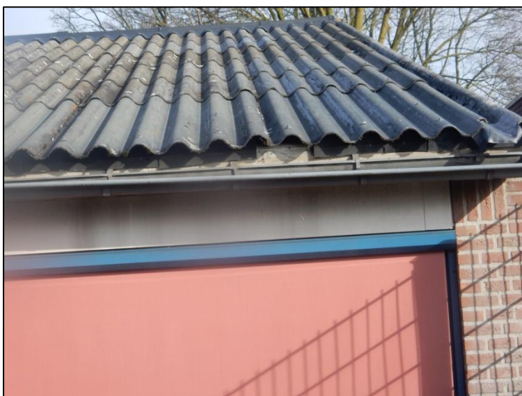
Figuur 12. Afgesloten openingen onder golfplaten schoolgebouw Elckerlyc.
