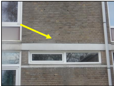
Figuur 19. Openstootvoegen in muur.
