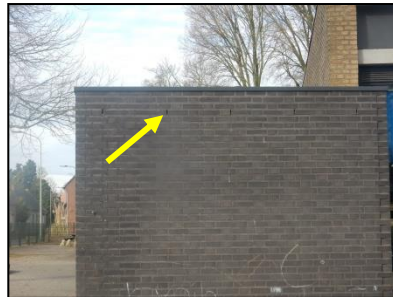
Figuur 20. Open stootvoegen in muur.
