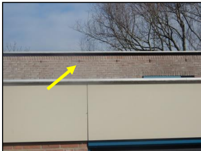
Figuur 22. Openstootvoegen in muur.
