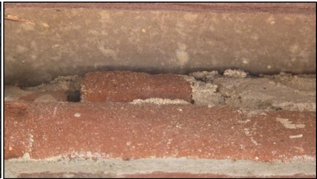
Figuur 12. Geschikte openingen onder dakrand welke mogelijk toegang verschaffen tot spouwmuur.
