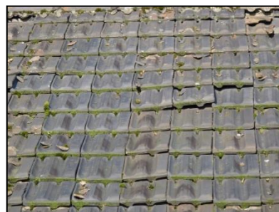
Figuur 8. Verspreid over het dak openingen tussen dakpannen.
