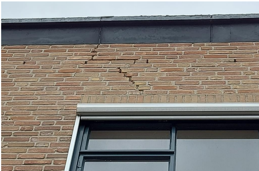
Figuur 4: Open stootvoegen en een scheur in muur die voor vleermuizen toegang geven tot de spouw.
