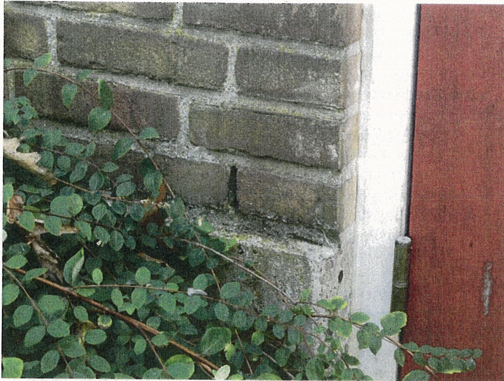
foto 6: Spleet in muur van gebouwM1 (datum: 10.10.2008)
