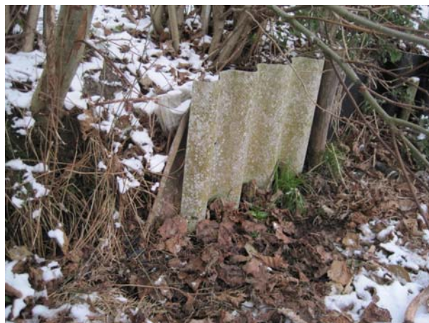
Fotonummer: 2 Omschrijving: asbest verdachte beschoeiing
