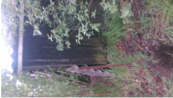
Fotonummer: 7 Omschrijving: Asbestgat 06
