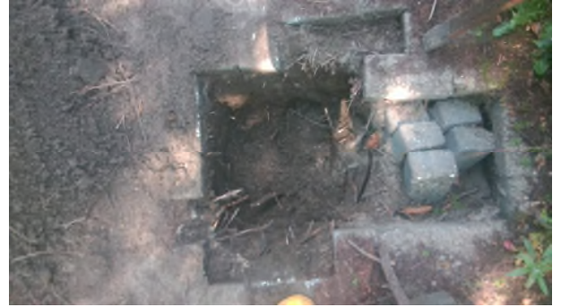
Fotonummer: 8 Omschrijving: Asbestgat 014A
