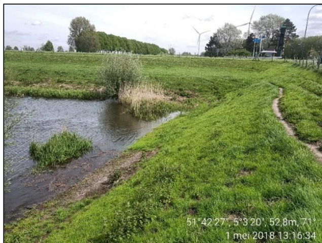
Figuur 7: binnentalud grondlichaam met tredschade (mogelijk een schapenpaadje)
