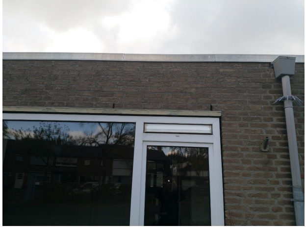
Stootvoegen aanwezig in de gevel. Foto: C.E. Bakker | Ecoresult B.V.
