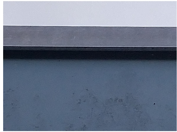
Afbeelding 5: Ruimte aanwezig tussen het boeiboord en de metalen dakstrip. Foto: C.E. Bakker | Ecoresult B.V.
