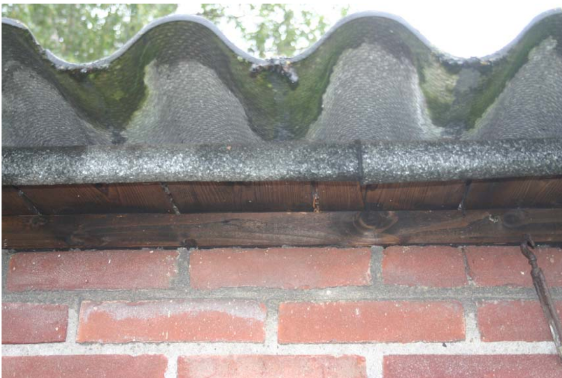
Foto 4.2.2. De ruimte onder elke 'golf' van de eternieten golfplaten zijn geschikt als nestlocatie voor vleermuizen en vogels als de huismus.
