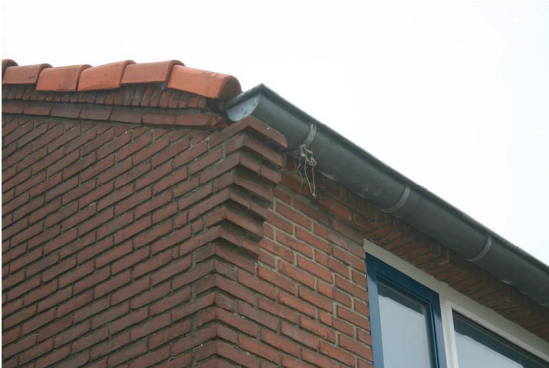
Foto 4.2.1. De ruimte onder de onderste hoekpan is geschikt voor vleermuizen en vogels als gierzwaluw en huismus.
