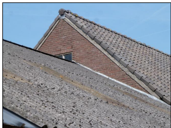
Figuur 10. Overhangende dakpannen aan de zuidzijde van het woonhuis.
