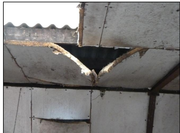
Figuur 15. Een potentiële nestlocatie van een kerkuil in de opening van het dakbeschot.
