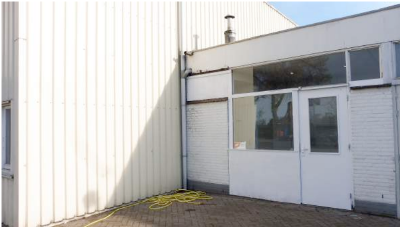
Het hoekje met de enigste rotte plek in het boelboard, ongeschikt als vleermuisverblijfplaats
