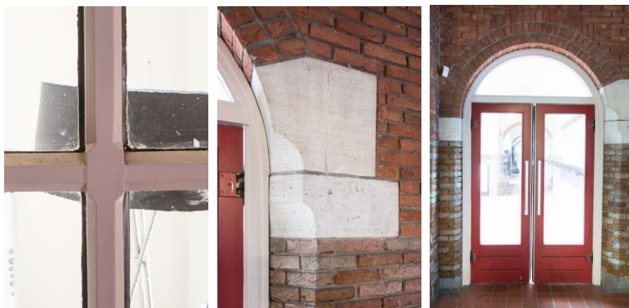
Detailering van deur en raamroeden met kapelletjes. In het midden typisch Krophollerelement en rechts toegevoegde pui die een belemmering vormt voor ervaring van de oorspronkelijke open gangstructuur.
