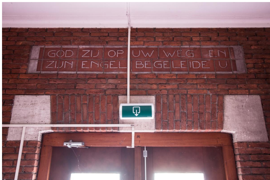
Karakteristieke ontlastingsconstructie, instructie in tegeltableau en waardeverminderende verrommeling met kabelgoten (en een deurdranger).
