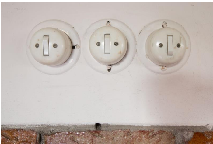
Schakelaars vermoedelijk uit de tijd van de uitbreiding in 1965, maar mogelijk nog uit 1939.
