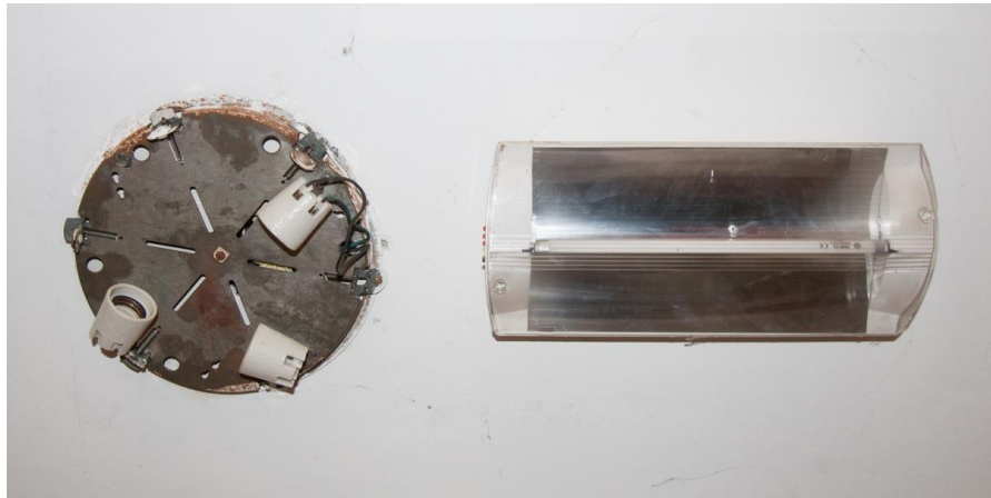
Lichtarmaturen tegen het plafond.
