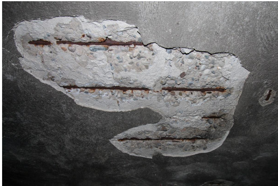
Gewapend begon van het kelderdek, de begane grondvloer ter plaatse van de gang.
