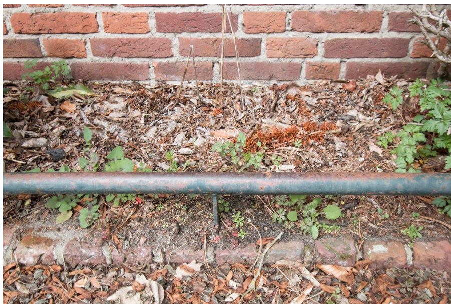
Borderafscheiding vermoedelijk uit de bouwtijd.
