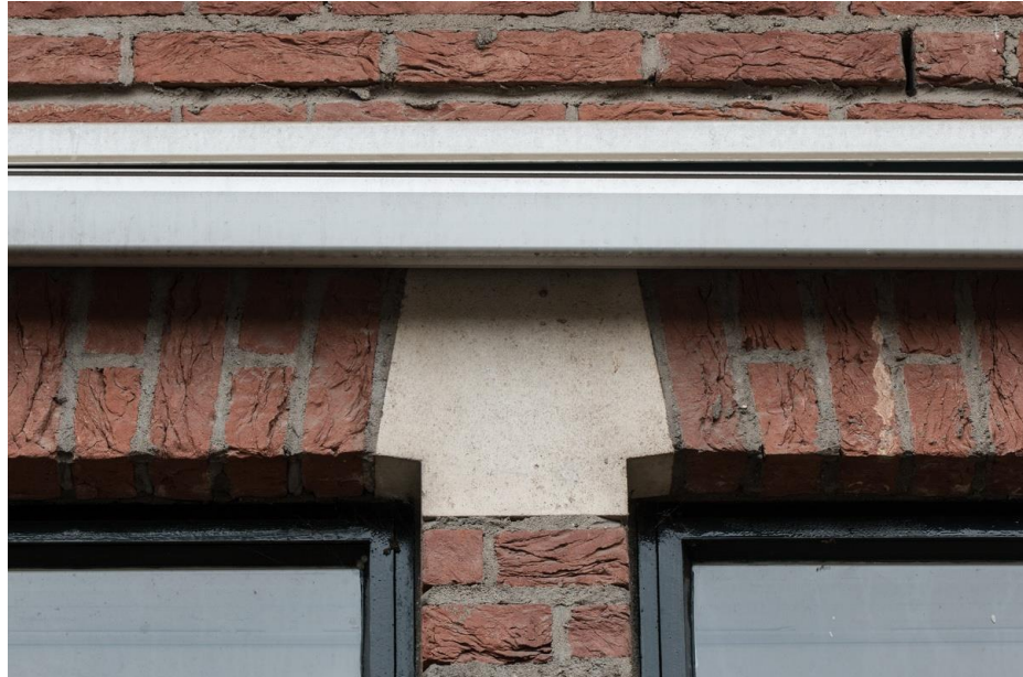
Bewerking van het natuursteen is bij de laatste fase machinaal. Het voegwerk is er ook anders van structuur.
