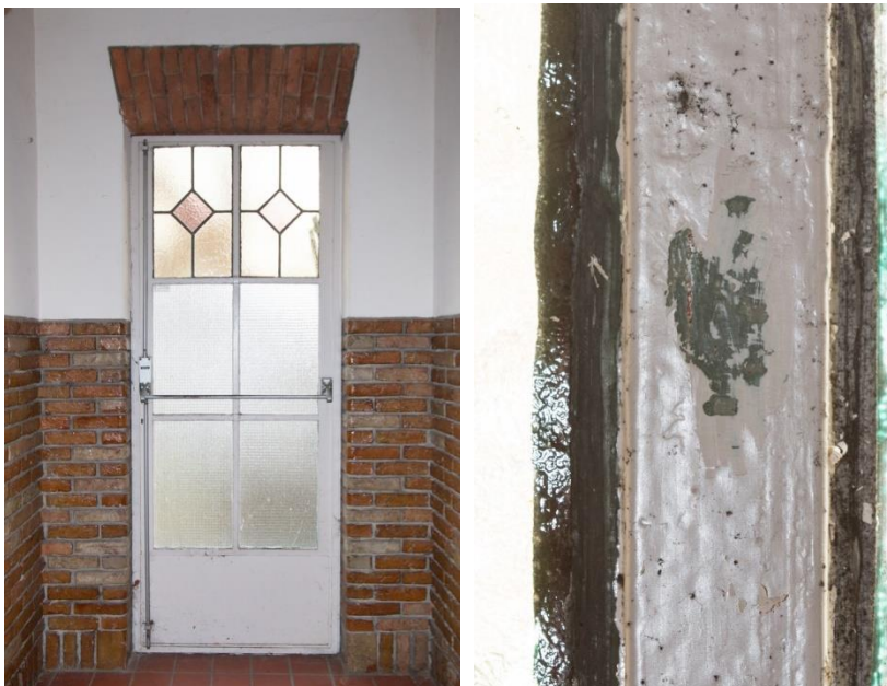
Achterdeur uit de bouwtijd met glas-in-lood, rechts oudere verf op stalen ramen in de achtergevel (interieurzijde).
