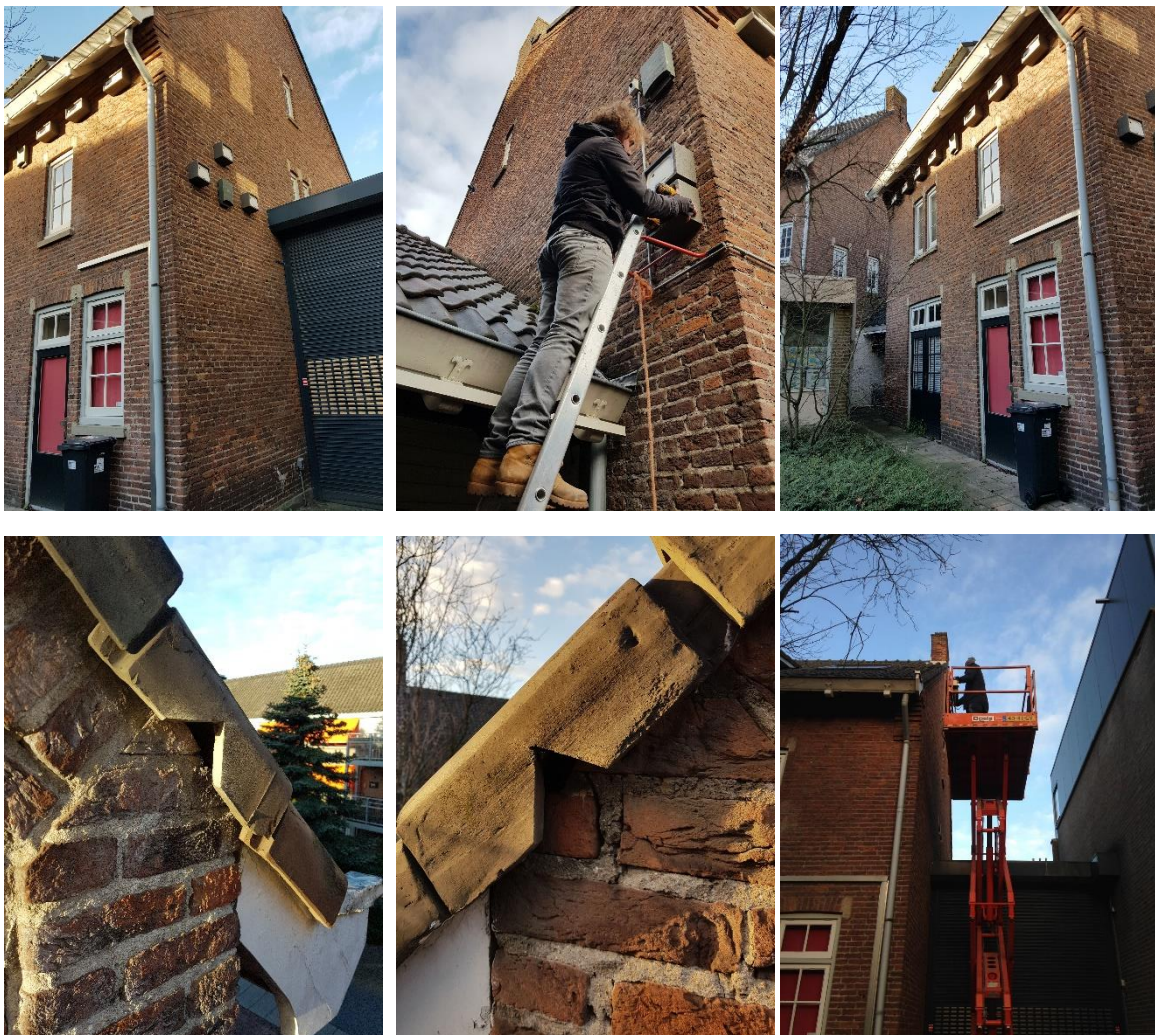
Linksboven: locaties van 3 gierzwaluwnestkasten, 2 vlermuiskasten en 3 mussenkasten. Middenboven: Gaston hangt 2 huismussenkasten op aan de zuidwestgevel. Linksboven: overzichtsfoto van de 7 gierzwaluwnestkasten en 1 vlermuiskast aan de zuidoostgevel. Linksonder: ingekepte gevelpan in het noordoostelijke dakdeel. Middenonder: ingekepte gevelpan in het noordoostelijke dakdeel. Rechtsonder: Met de hoogwerker hebben we 14 gevelpannen ingekeept met een slijptop, zodat deze toegankelijk geworden voor gierzwaluwen.
