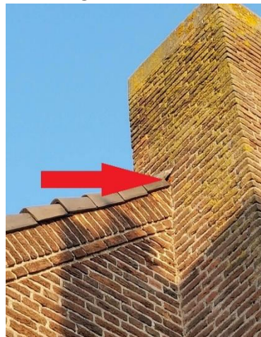
Figuur 12: GZ_2. Onder de bovenste gevelpan van de westelijke gevel van pand 3.
