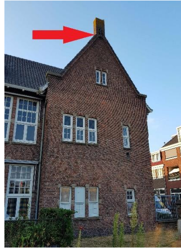
Figuur 15: GZ_5. Onder de bovenste gevelpan van de zuidelijke gevel van pand 3.
