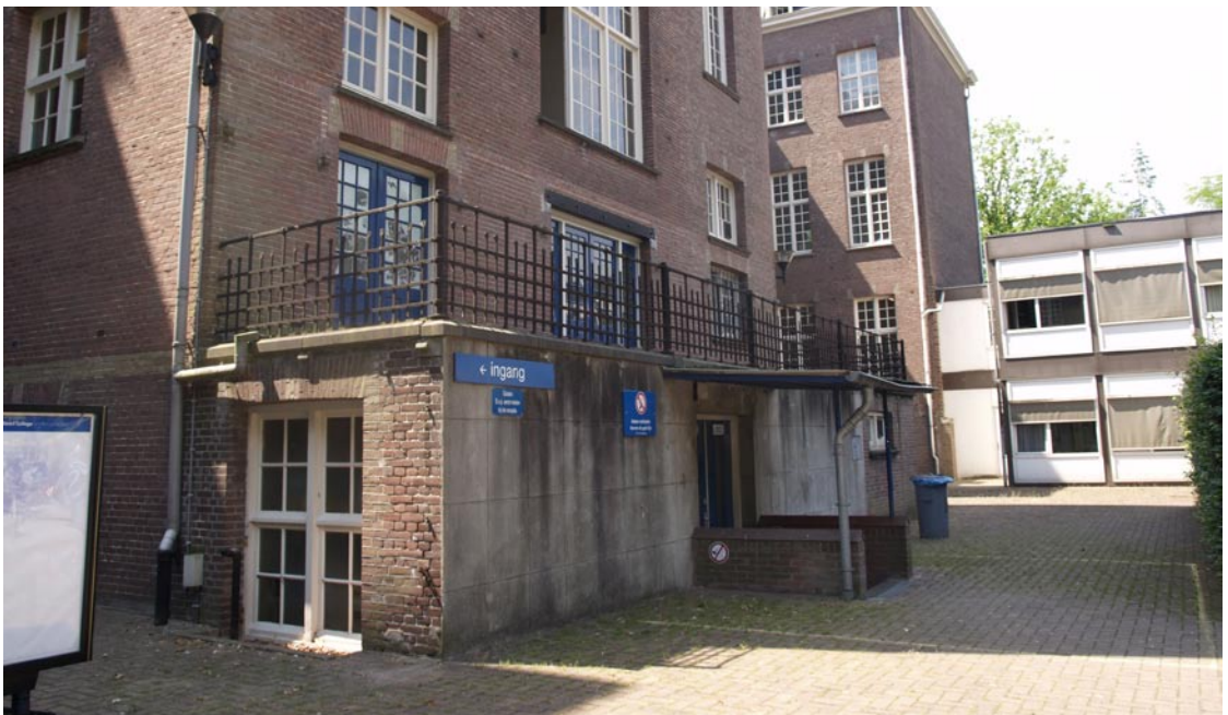
Afb. 7. De verkleuring in het metselwerk van de onderste bouwlaag van de middenrisaliet aan de achtergevel geeft aan dat hier wijzigingen zijn aangebracht. Oorspronkelijk bevond zich hier een dubbele bordestrap.
